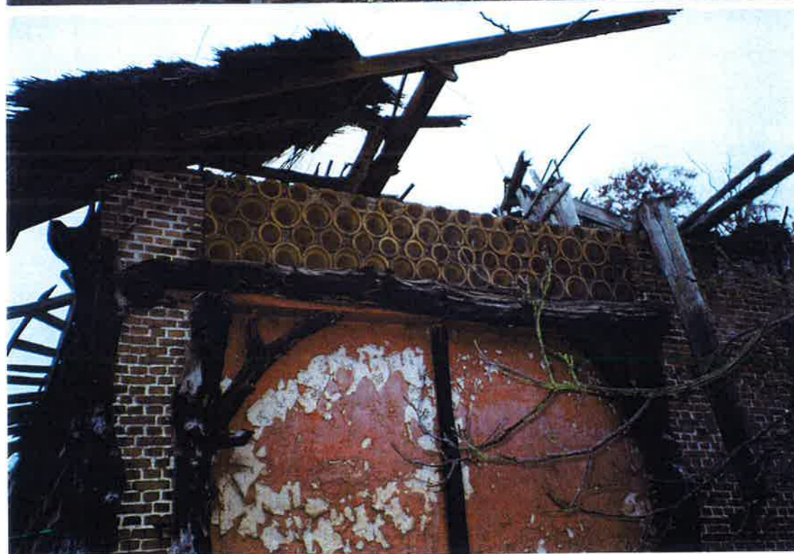
De voorgevel van de schuur in de huidige toestand, met de ingestorte top. De deeldeuren aan de linkerkant zijn schijndeuren. De linkerzijgevel is van hout. Detail van de schijndeuren in de voorgevel, met de ingemetselde drainagebuizen voor de ventilatie en de opgeplakte halve ruwe boomstammen (deze en volgende foto's H.F.G. Hundertmark, nov. '97, in archief SHBO).
