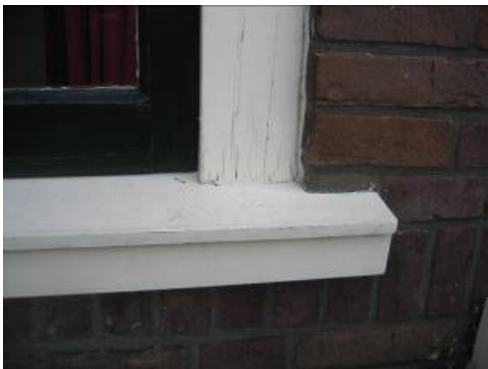
Klemmende ramen ter plaatse van de kozijnstijl.
